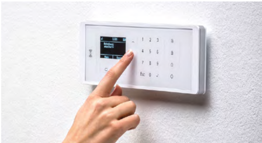
↗ Stationäres Bedienteil einer Alarmanlage mit Smart-Home-Funktionen
