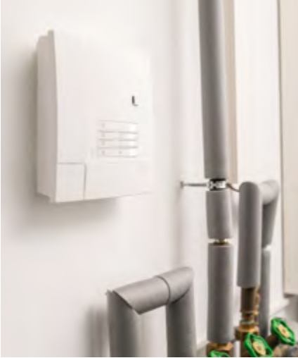
^ Zentrale einer Alarmanlage im Haustechnikraum
